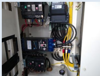
電子ブレーカー設置 (7物件導入済み)
