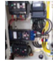
電子プレーカー設置 (7物件導入済み)
