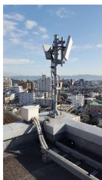
屋上アンテナ
