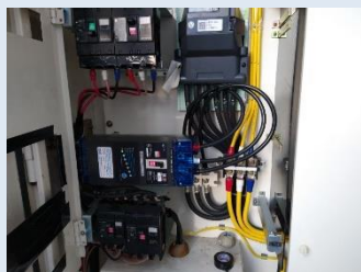
電子ブレーカー設置 (7物件導入済み)
