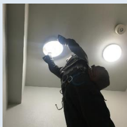
LED照明設置 (11物件導入済み)
