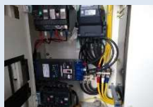
電子ブレーカー設置 (12物件導入済)
