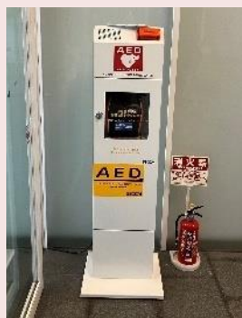
AED設置 (MRRデルタビル 他)
