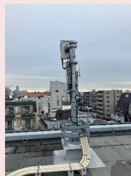
携帯電話等基地局設置 (アルティザ池尻)
