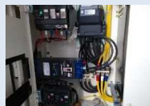
電子ブレーカー設置 (12物件導入済)
