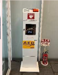
AED設置 (MRRデルタビル 他)
